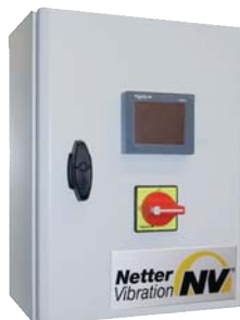
Частотные контроллеры SRF монтируются в распределительный шкаф класса защиты IP 54
